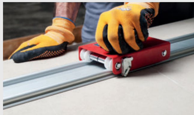
CUTTING DETAIL WITH GUIDE ON SLAB DETALLE DE CORTE CON GUÍA SOBRE PLANCHA
